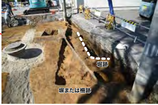
内堀跡(東側)と並行する堀または柵跡 堀または柵跡の底面には柱を建てたとみられる 穴が見つかった
